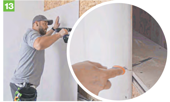
13 Gipskartonplatten fixieren Nun kommen die Gipskartonplatten. Du kannst sie einfach über die Nischen schrauben und die Nischen dann mithilfe einer Handsäge ausschneiden. Vergiss nicht, die Ränder mit einem Raspelhobel zu glätten. Zum Anschrauben auf Holz verwendest du Schnellbauschrauben mit großem Gewinde.
